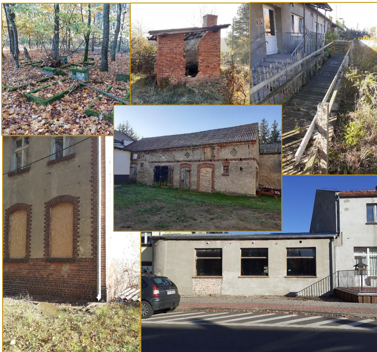
Rysunek 23 Zdegradowane obiekty w granicach obszaru rewitalizacji (od lewej strony: budynek cmentarz w Lewiczynku, pomieszczenie gospodarcze przy dworcu w Lewiczynku, pochylnia przy dawnej restauracji w Miedzichowie, budynek dworca w Prądówce, dawna restauracja w Miedzichowie, na środku pomieszczenie gospodarcze przy Świątlicy Wiejskiej w Jabłonce Starej
