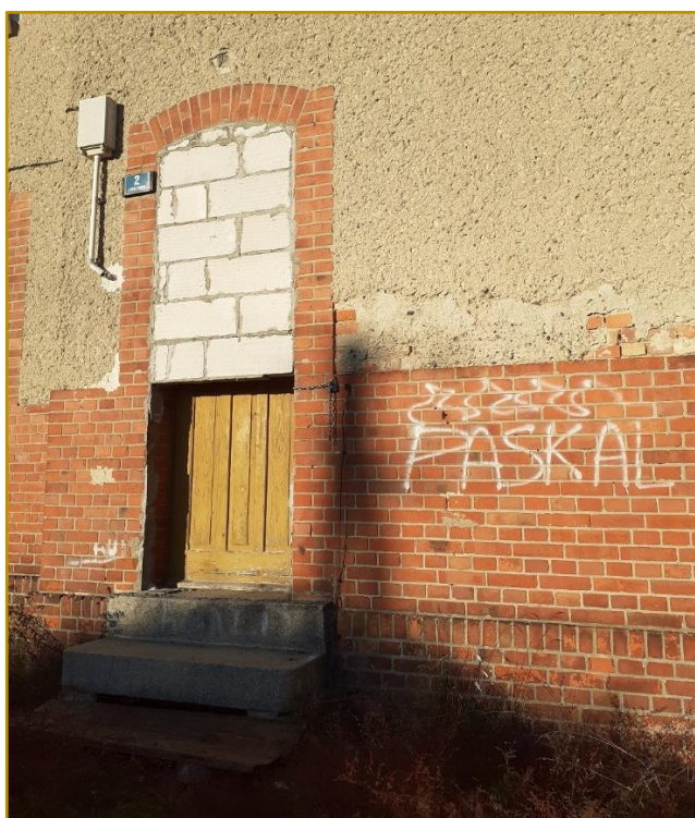
Rysunek 12 Przykład aktu wandalizmu na podobszarze rewitalizacji Lewiczynek: graffiti na budynku po dawnej stacji kolejowej
