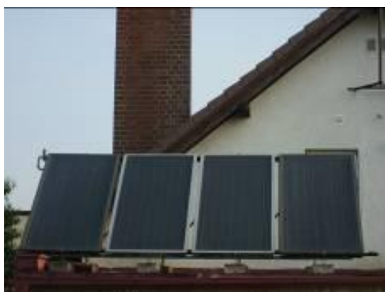
Ryc. 6.2. Kolektory słoneczne do ogrzewania wody użytkowej na budynku mieszkalnym w Bolewicach
